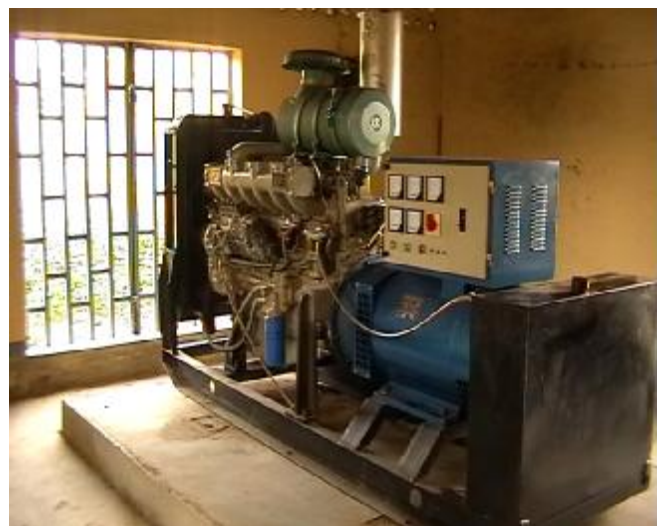
Le groupe électrogène de 80 KVA
